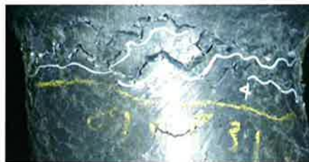
写真 2.2.3 関東の建物で確認(深さ 震災後約30mm)
