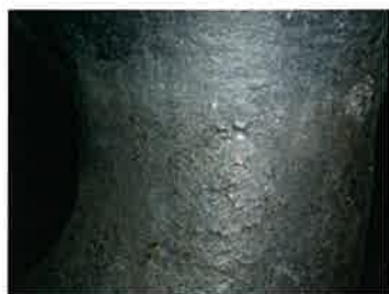
写真 2.2.1 関東の建物で確認(深さ:約3mm)
